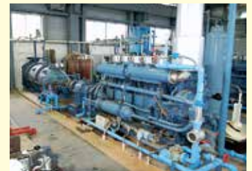
50年経過し老朽化したエンジンとポンプ
