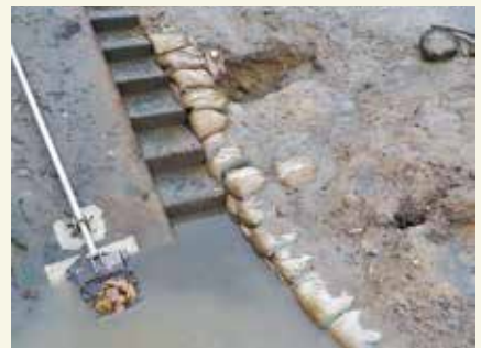
金谷ため池と陥没状況
