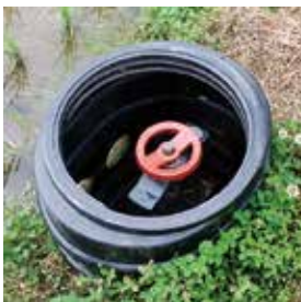
給水栓 (地下かんがい給水孔付)
