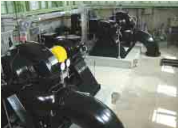
新設された揚水機
