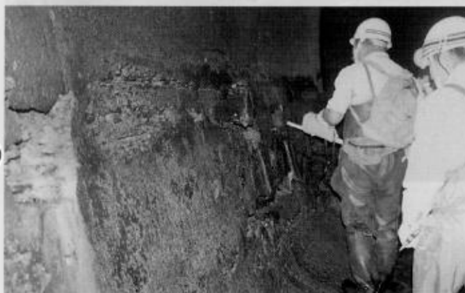
補修の待たれるトンネル内の劣化状況
